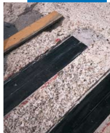
Plats Carboplate engravés dans le béton
