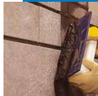
Autre exemple d'application d' Ultracolor Plus à la spatule en caoutchouc en mur
